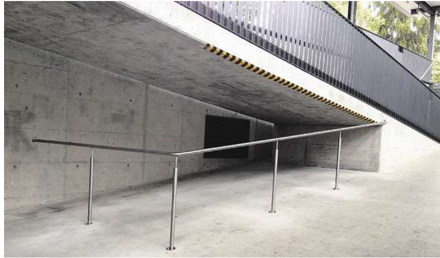
Gefahr gebannt. Gesicherte SBB-Unterführung in Sissach. Foto Alexander Müller
